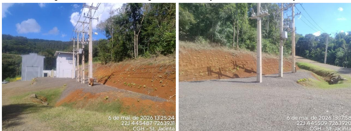
Figura 8: Canaletas às margens da subestação e linha de distribuição.
