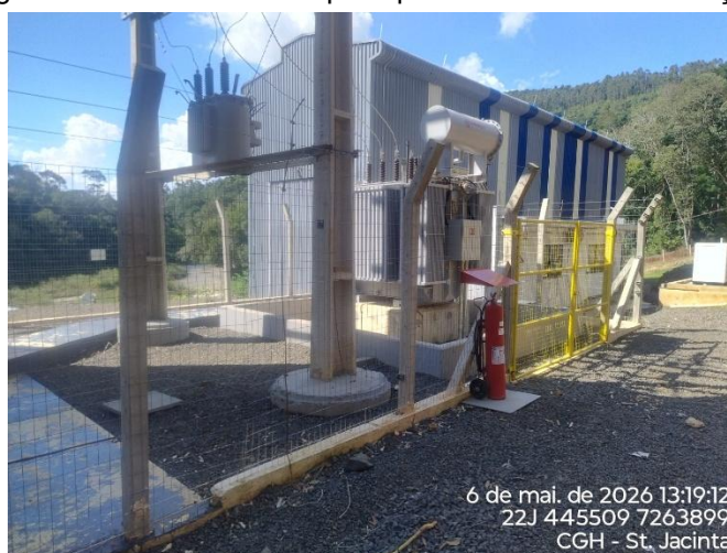
Figura 4: Transformadores principal e auxiliar na Subestação.
